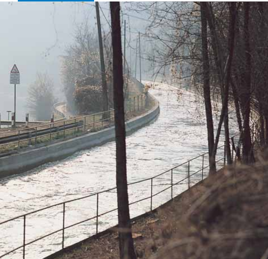
Canalul hidro-electric Bertini - Como, Italia. Suprafata a fost tratata cu Idrosilex Pronto
